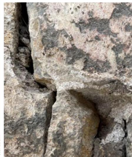
Riss auf der Ostseite des Kirchturmes Windischholzhausen
